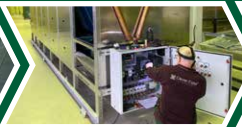
Сборка электрических шкафов управления
