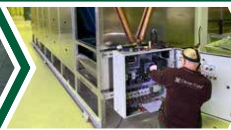
Сборка электрических шкафов управления
